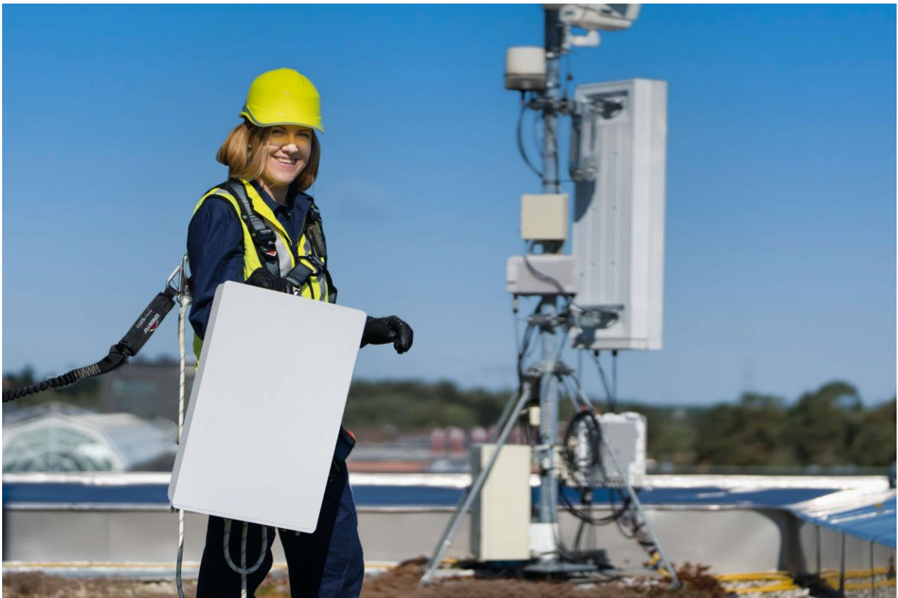
Installazione di antenna radio Ericsson Air 3268 su un tetto.
