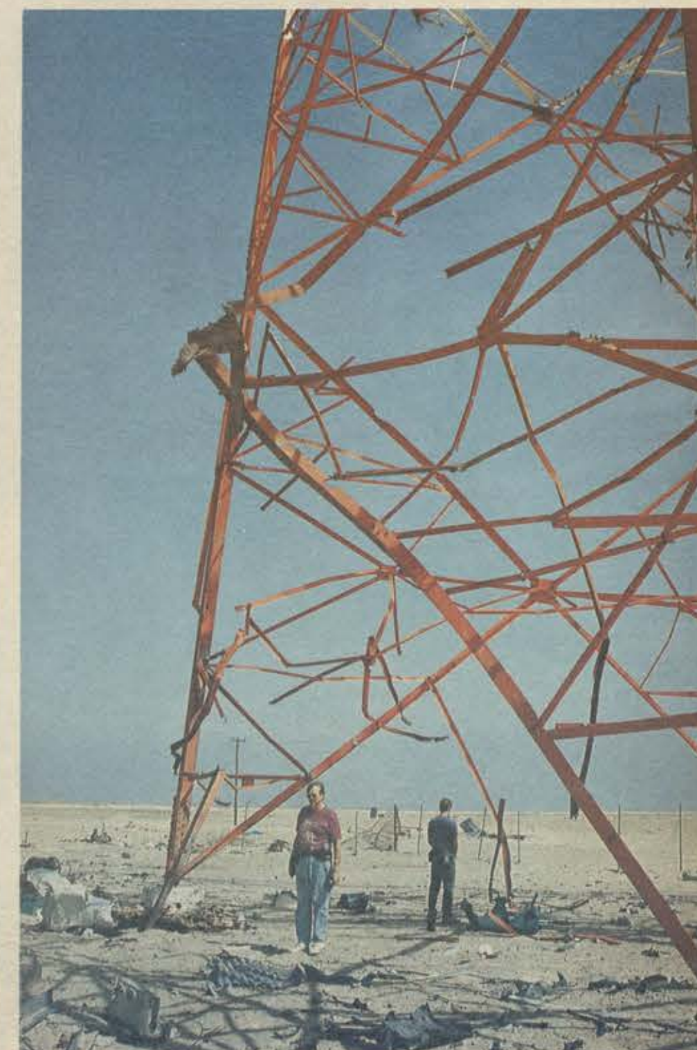
▲ Detta är basen på ett 100 meter högt radiolänktorn vid site Salmi 1 som sprängdes under kriget. De flesta basstationer inne i Kuwait City har klarat sig, men i övriga landet är 90 procent förstört. De gamla siferna där basstationerna står kan kanske användas, men transmissionsnätet måste byggas upp på nytt. Det ersätter i så fall Kuwaits förra mobiltelefonnät, som var ett japanskt NEC-nät. Innan kriget tänkte man att Ericsson-utrustningen skulle kopplas in på NEC-nätet. Men den NEC-utrustningen fördes bort av irakierna, som har just NEC-växlar. De tog snyggt och prydligt med sig all NEC-utrustning de kunde. Ericssons installerade utrustning var däremot ointressant och fick vara kvar - tursamt nog.
