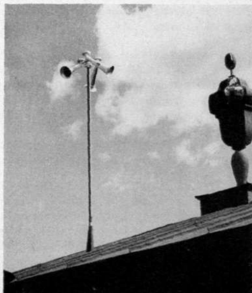
Fig. 3 Kompressordrivet tyfonaggregat X 7856 t. v. trippeltyfon på stödrör, t. h. ventilskåp, kompressor och luftbehållare
