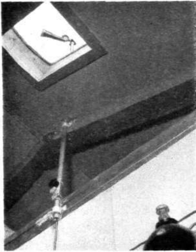
Fig. 7 Högtrycksaggreat monterat på vin- den i en fastighet på stödröret mikrofon för ljudprovning av aggreatet från manövercentralen
