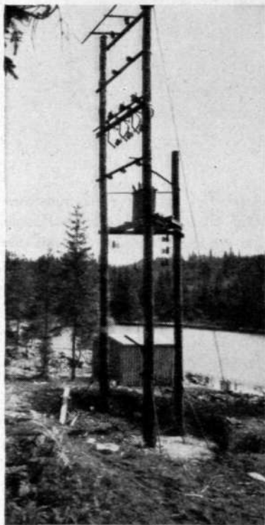
Fig. 1 Pumpehuset med høispenningsledning og transformator
