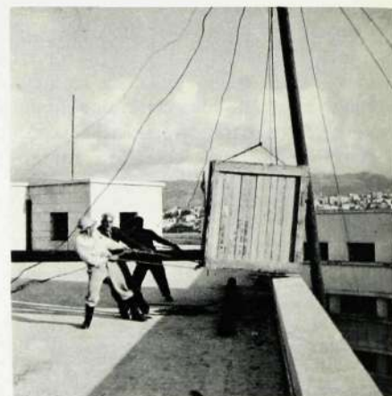
860 kilo vägde ett kylaggregat avsett för reservkraftanläggningen för nya telestationen i Beirut. Aggregatet gick inte att ta in trappvägen. Ett försök att låna någon av de många amerikanska helikoptrar som opererade i Libanon under krisen där misslyckades - amerikanerna var rädd att helikoptern skulle bli beskjuten - men till slut löste man problemet med hjälp av pålar, wires och kraftiga armar.
