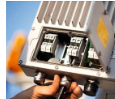
En Remote Radio Unit installeras ombord på Maersk Penang.
