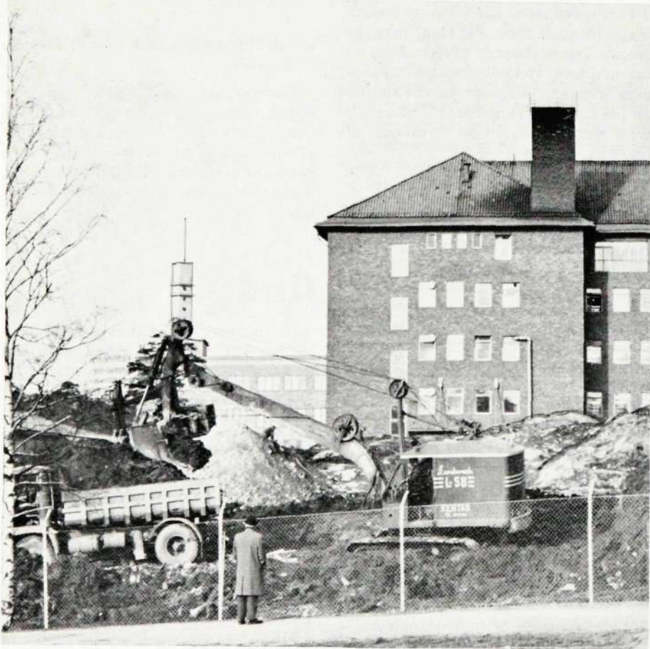
Ett nytt kontorshus ska uppföras på Tellustomten i Stockholm, där grävskoporna nu börjat arbeta. Det första »spadtaget» togs den 21 februari 1967. Man planerar ett nio våningar högt hus, vilket ger en golvyta av ca 15 000 kvadratmeter. Det är ännu inte bestämt vilka som ska »bo» i huset, men inflyttningsklart blir det under första halvåret 1969.
