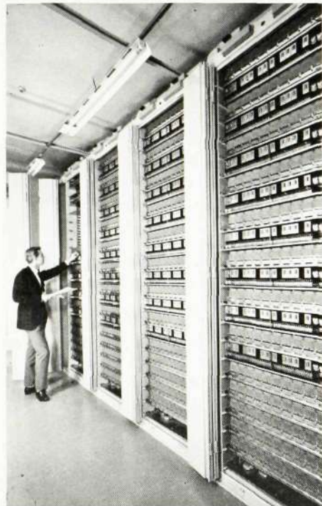
Rolf Nilsson, HFIX/Itte, inspekterar abonnenternas väljarutrustning.
