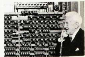
Världens första koordinatväljarväxel från 1919 med konstruktören och mångåriga LM:aren Ing. Nils Palmgren , 84 år.
