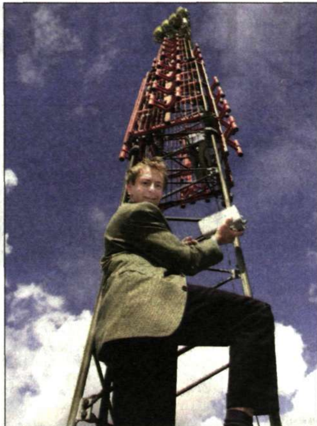
Ulf Sundström demonstrerar förstärkaren TMA som monteras nära antennerna uppe i masten. Där förstärker den de inkommande signalerna från mobilerna.
