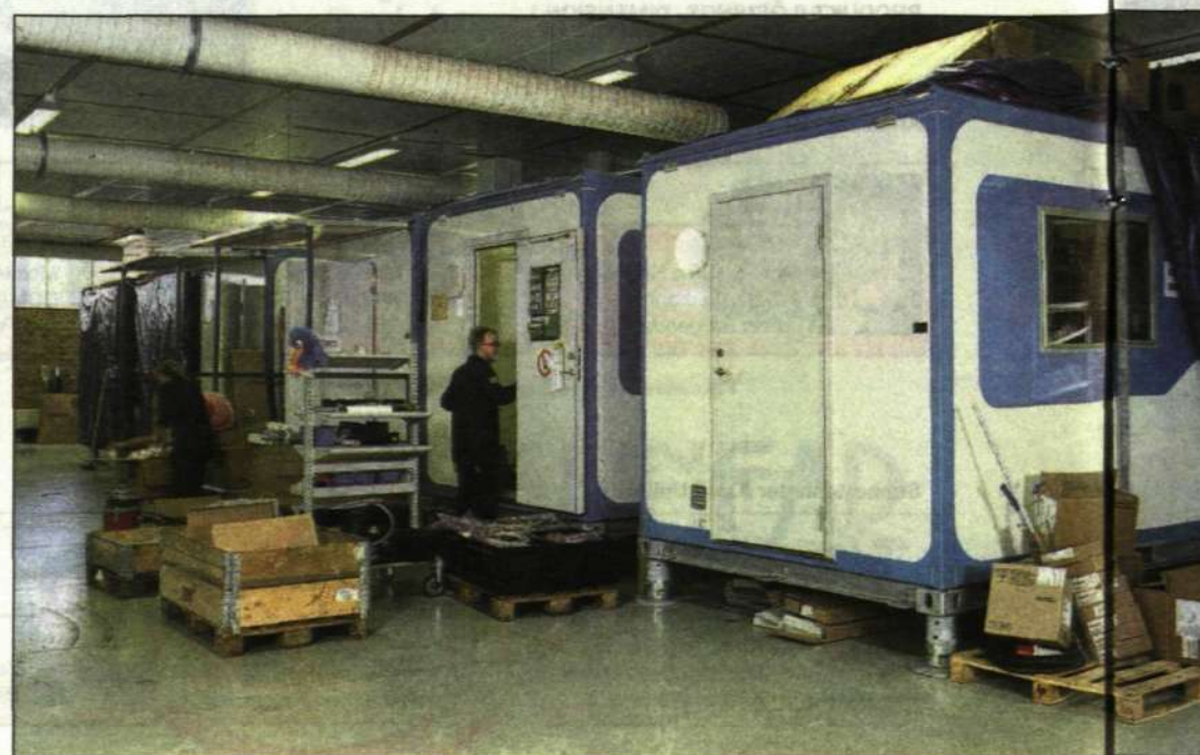
Testsystemet för 3G installeras i två större och en mindre container.
