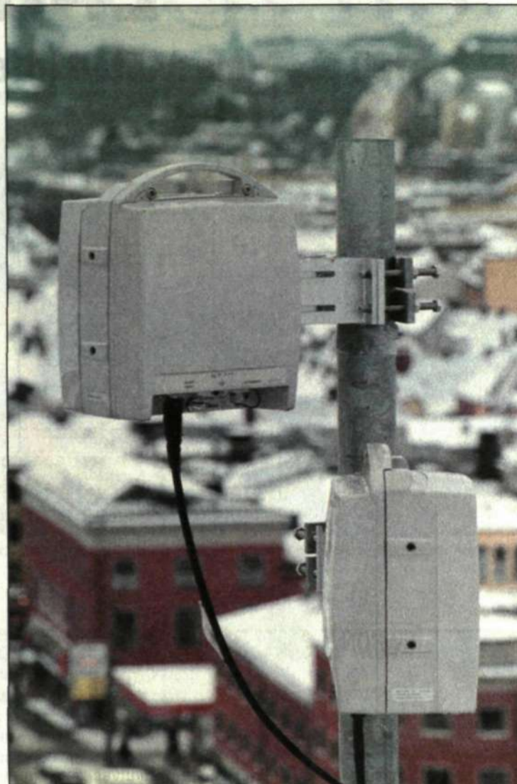
Mikrovågsverksamheten står för två tredjedelar av verksamheten i den nya affärsenheten Transmission och transport, resten är optoteknik. Den här mikrovågsanläggningen, en MINI-LINK BAS, finns i Oslo.
