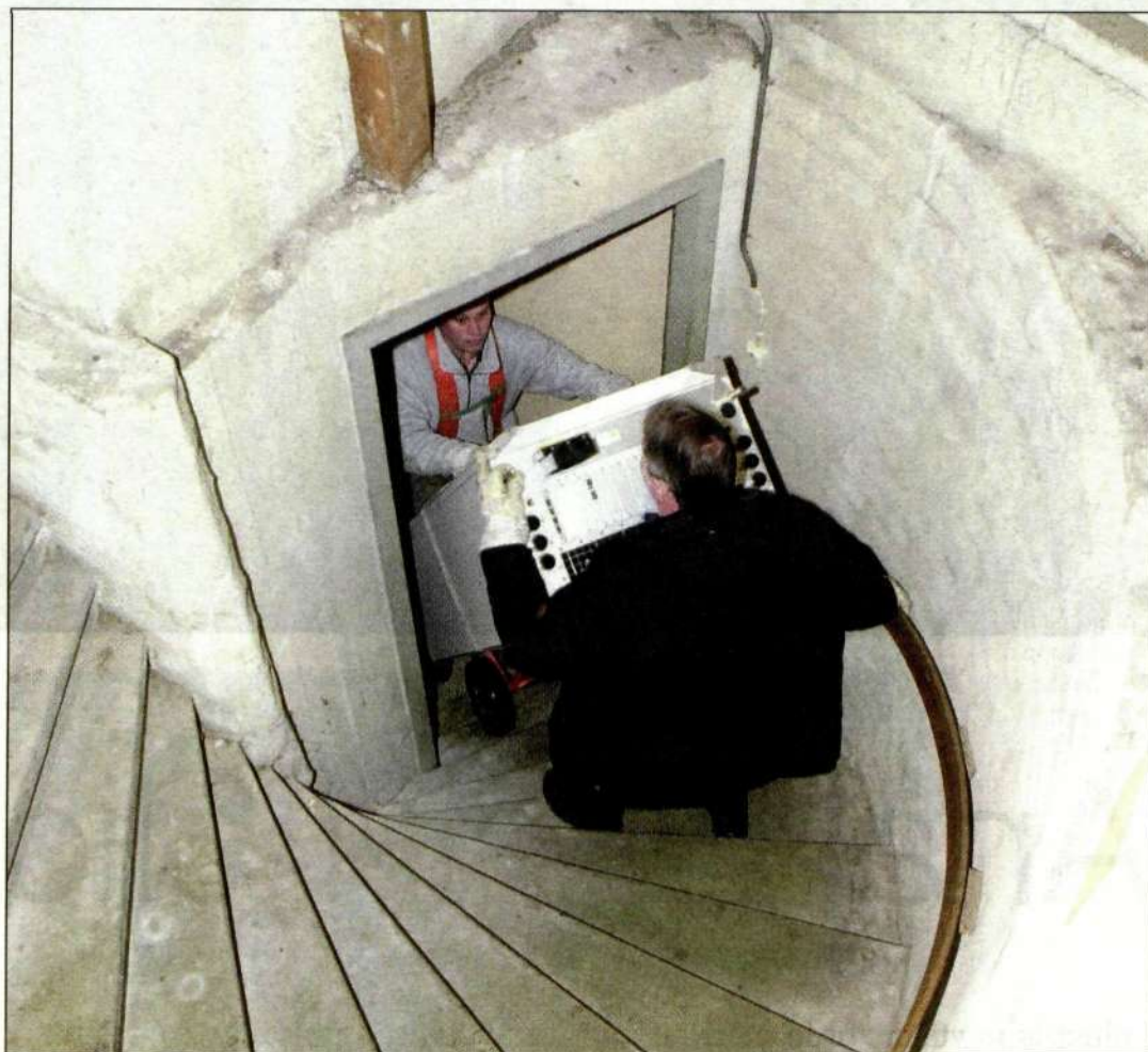
3G-näten rullas nu ut för fullt och operatörerna behöver mycket stöd. Ericsson har möjligheter att ge skräddarsytt stöd. På bilden en installation av WCDMA-basstationer i Sverige.
