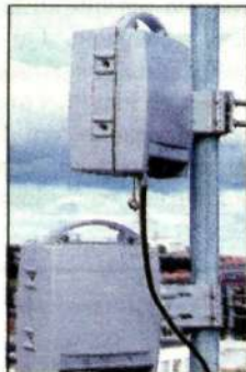
En installerad MINI-LINK BAS.
