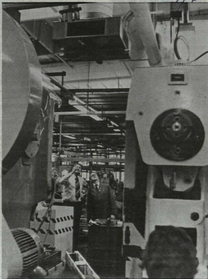
Verkmästare Lennart Stranneborn och skyddsombudet Bertil Höglund (Vt 17) ser upp mot en av fläktarna på avdelningen. Systemet heter DIRIVENT och har s k jetstrålar.
