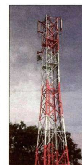
Ericsson installerar i år tusentals basstationer i 18 nya mobilnät i landet. Detta är delar av ett system i Hutchisons nätverk.
