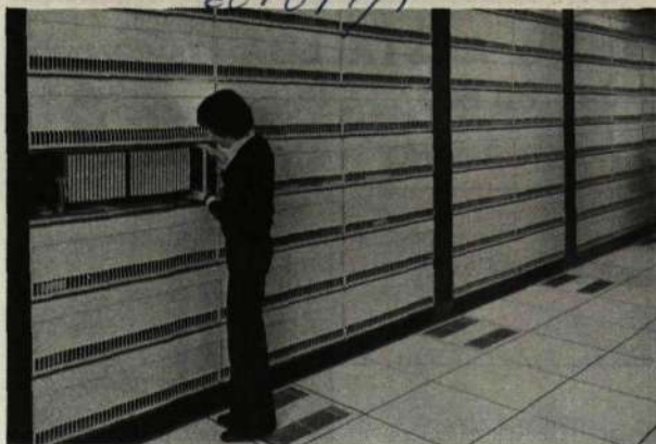
Elektronikhyllor med reedväljare i nytt datorstyrt lokalstationssystem utvecklat inom ELLEMTEL. Reedväljarna är uppbyggda med små tungelement utvecklade av RIFA.
