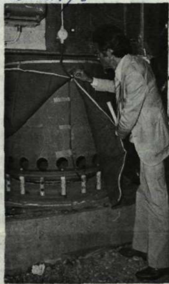
Olle Olsson vid en av de chockdämpare som sitter mellan grottgolv och husgolv och som ska ta upp skakningar vid bombfällning.
