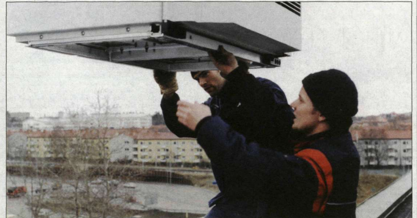
En installation av en 3G-basstation i Nacka utanför centrala Stockholm.
