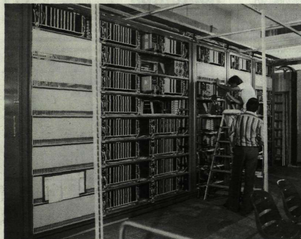
AXE-installation i Riyadh-växeln.
