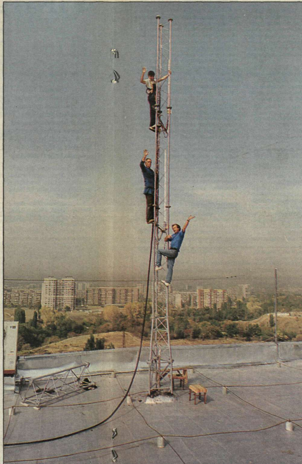
MED SIKTET STÄLLT PÅ STJÄRNORNA. NMT-antennen monterats på site 74 i Sofia. Bilden togs i oktober. Då började nätet byggas upp för att redan till julen kunna tas i drift.
