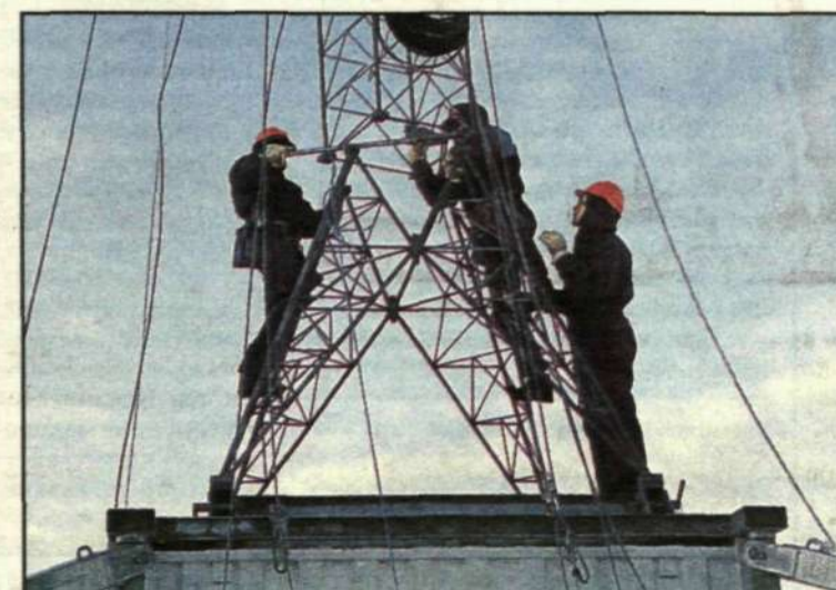
Det spännande sista momentet – masten sammanfogas med sitt fundament. Klappat och klart!
