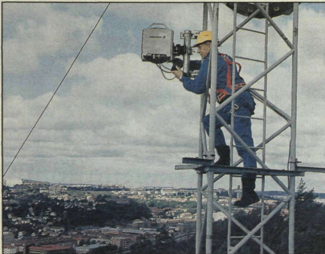
Mini-Link-utrustningen som kan installeras mycket snabbt är en avgörande länk i bl a mobiltelefonens erövring av världen. Foto: Pelle Lund
