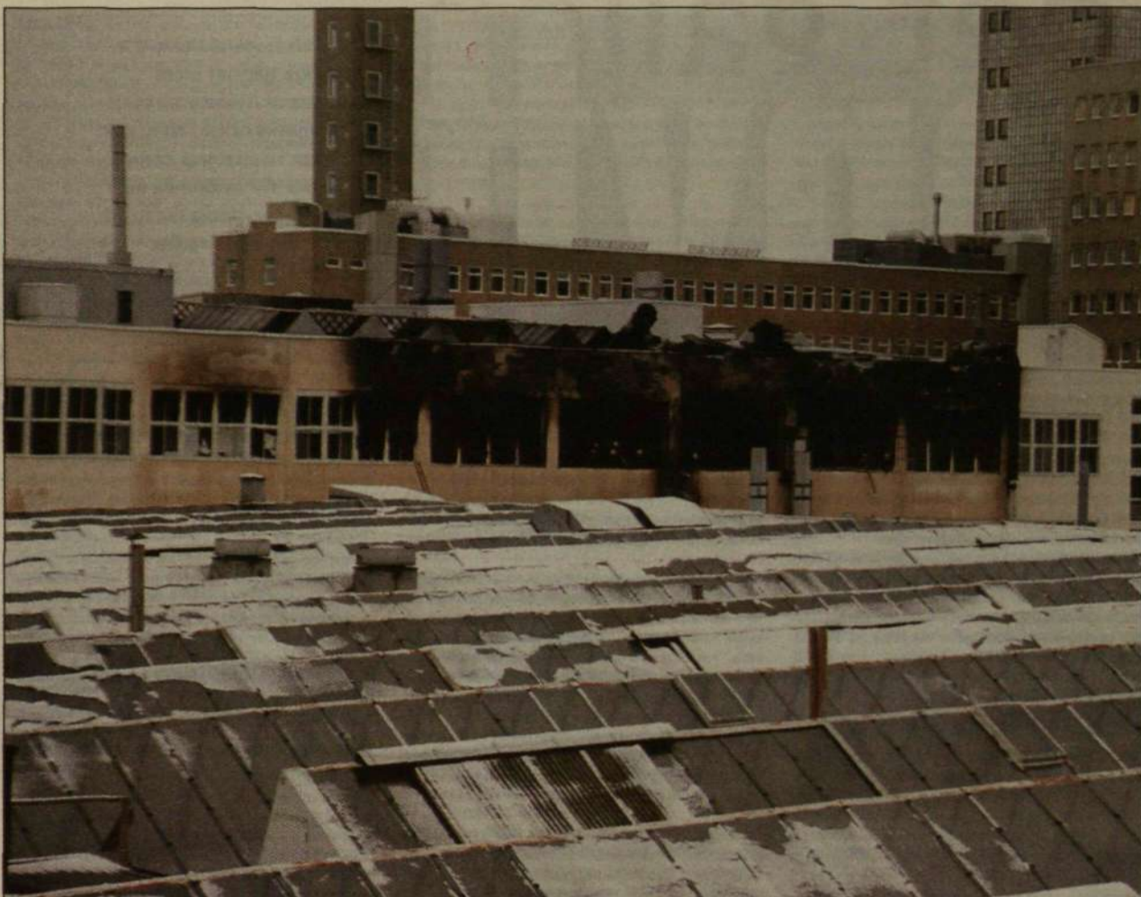
Ericssons fastighetsbolag fick stora delar av sina lokaler för svagström och nät helt förstörda av branden. De utbrunna lokalerna på bilden ligger rakt ovanför Ericsson Telecoms ytbehandling där branden började. Foto: PATRIK LINDÉN
