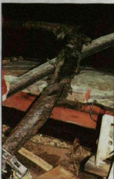
Här är den avslitna kabeln. Klämmorna i kabelns ände används för att förhindra ytterligare oljeläckage.
