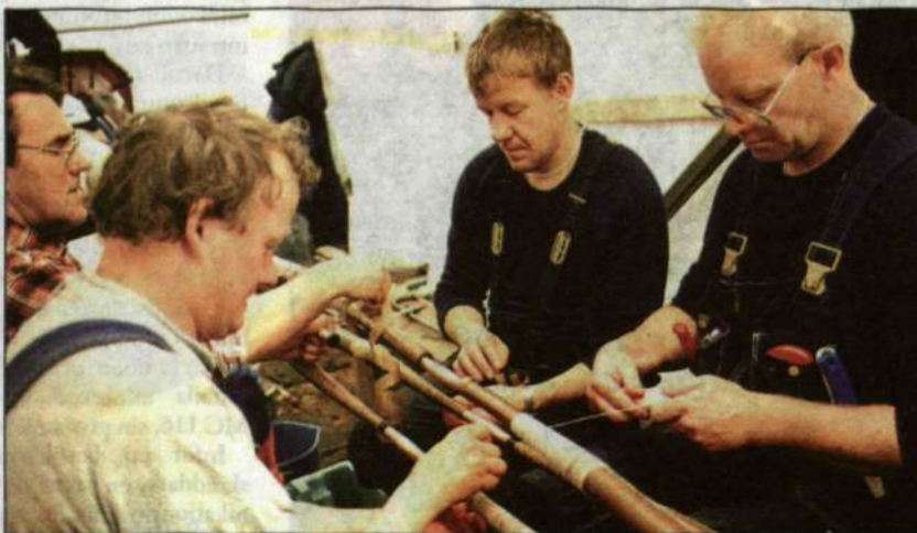
Delar av Team Ericsson Cables – (fr. v.) Sixten Andersson, Peter Tëging, Bo Wikström och Gustav Norling – under precisionsarbetet med att pappersisolera ledarna i kabeln. Som synes kunde arbetet inne i arbetsbaracken ske tämligen komfortabelt.
