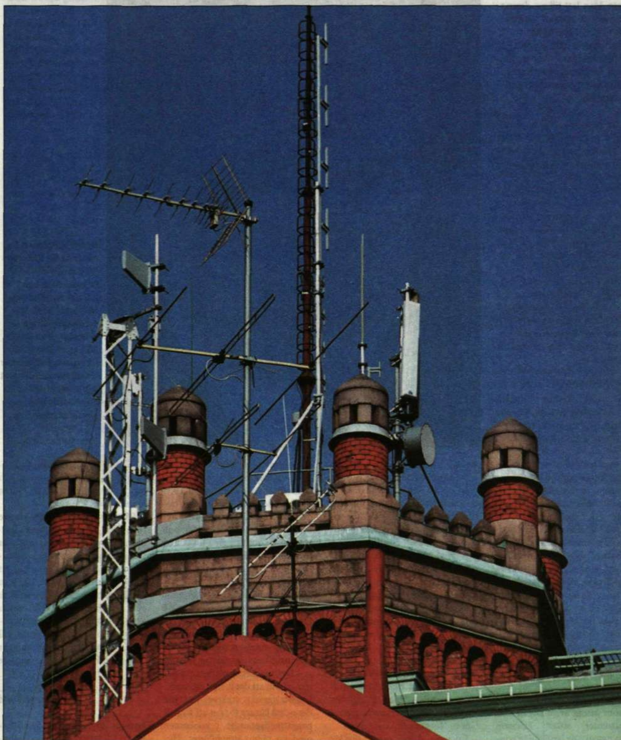
Utrustningen för mobiltelenäten är numera en etablerad del av statsbilden i Stockholm. En studie utförd av Ericsson och AT&T visar att näten dock har liten påverkan på miljön.
