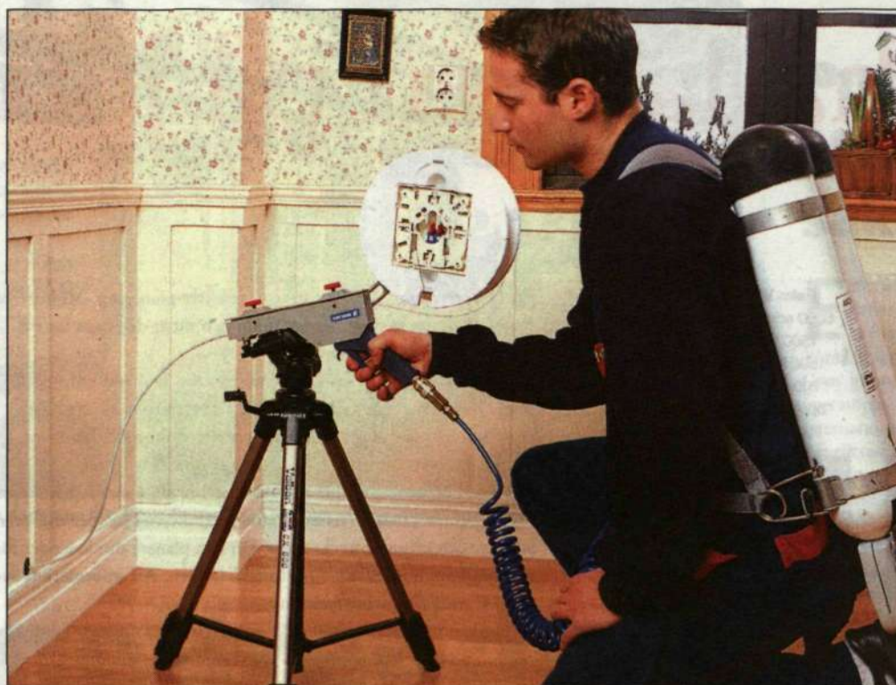
Flera bostadshus i Hudiksvall har fått fiberkabel installerad av Ericsson Cables system där den tryckluftdrivna pistolen ingår. I slutet av juni startar ett nytt projekt i ett bostadsområde i Vällingby i västra Stockholm.
