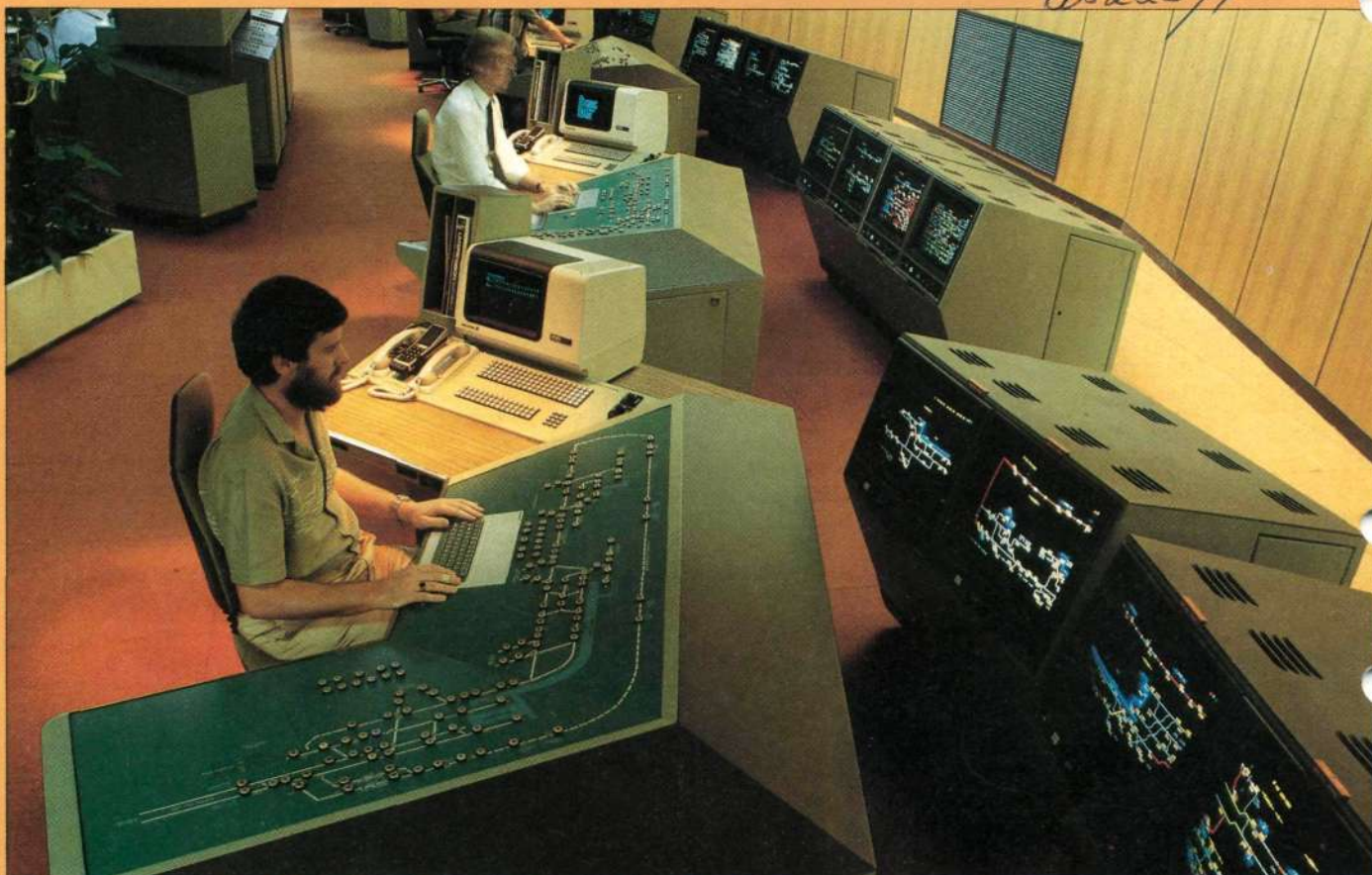
Det här är Metropolitan Train Control Centre, förkortat METROL. Och det är världens största datoriserade styr- och övervakningssystem, konstruerat och levererat av Ericssons signalavdelning i Stockholm.
