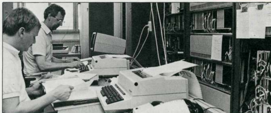
Kontrollrummet till en AXE-station. Försäljningen av AXE har nu gått något sämre än beräknat. Men samtidigt har vi gjort strategiska intåg i både USA och England.
